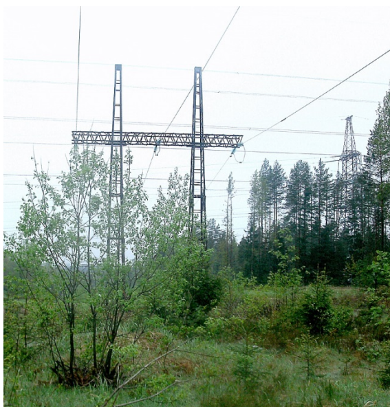
Рис. 2.6. Техническая трасса коридора ЛЭП. Пример антропогенной фрагментации.
